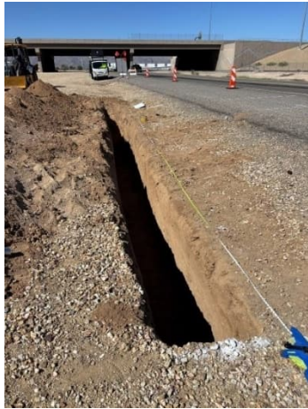
Earth Fissure Trench 1
