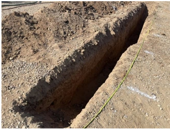
Earth Fissure Trench 2
